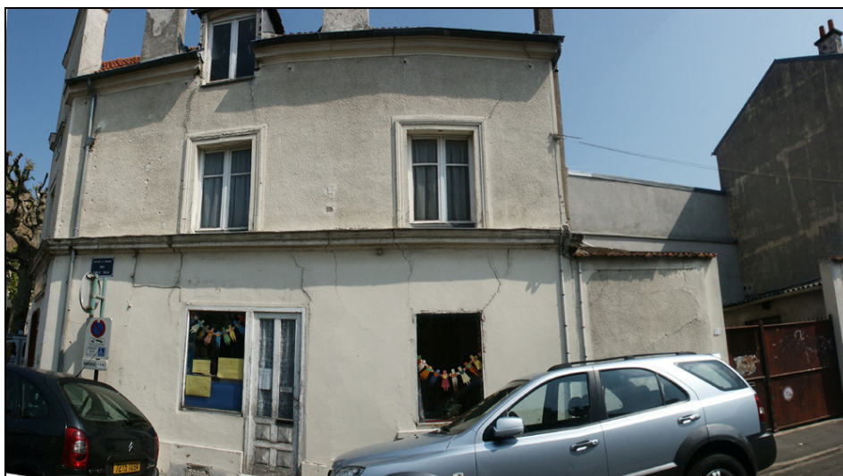
Position 4 : 30 Rue Emile Zola, Nogent/Marne, en vue panoramique. La dissymétrie des fentes de tension révèle que la partie droite du bâtiment s'affaisse relativement à la partie gauche.
