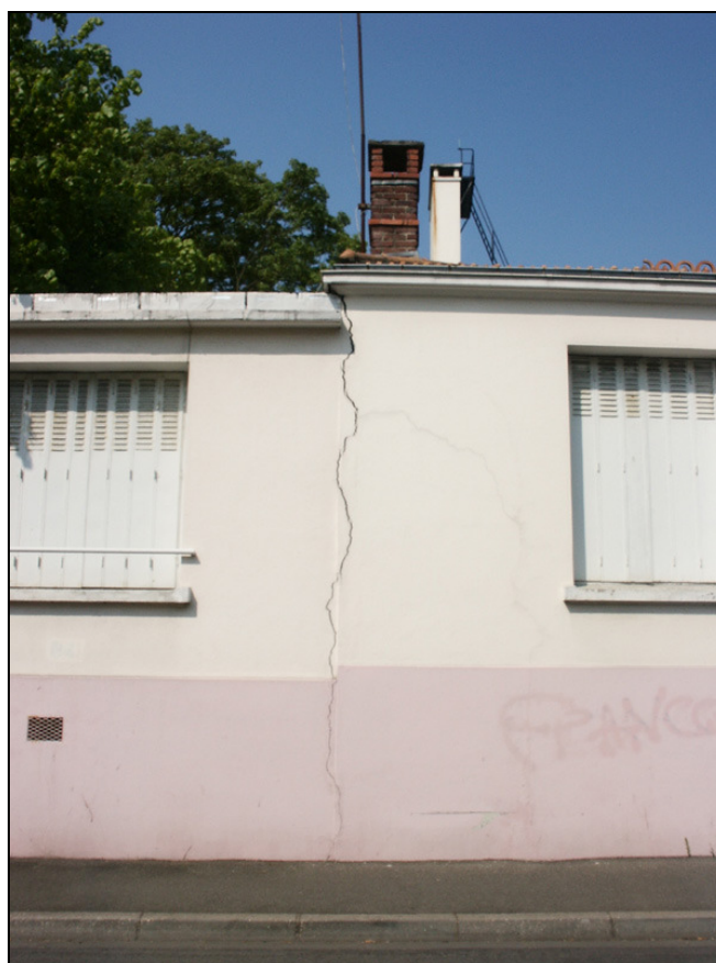
Position 3 : 5 Rue de L'Ardillière, Nogent/Marne, la diminution de l'épaisseur de la fente à proximité du sol révèle la présence d'une fente d'extrados. La partie droite ou la partie gauche s'affaisse engendrant la flexure du mur. Il est possible de quantifier le mouvement maximum en mesurant l'ouverture de la fissure.
