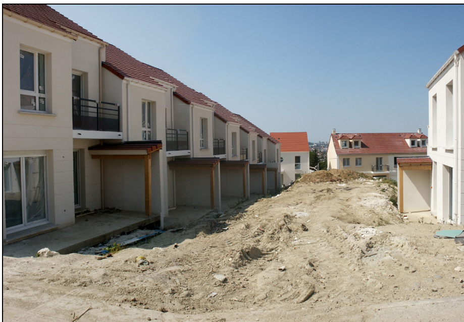
Position 3 : Lotissement en cours de construction fin 2006 sur des terrains argileux, et en pente, fortement susceptible d'être activé par le RGA à Bry/Marne.
