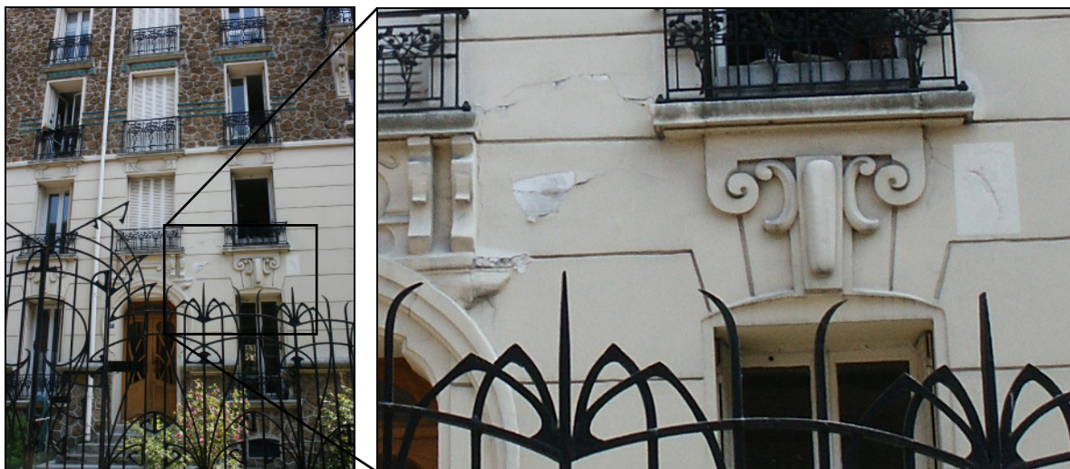
Position 2 : 1 er Rue Bauyn de Perreuse situé à Nogent/Marne. Remarquer la présence de fissures sur la façade ; la partie gauche du bâtiment s'affaisse relativement à la partie droite (voir localisation sur l'orthophoto).
