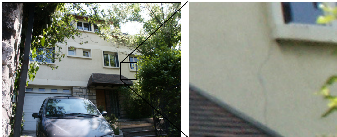
Position 4 : 75 bd Pasteur, Bry/Marne, la partie droite du bâtiment s'affaisse relativement à la partie gauche.
