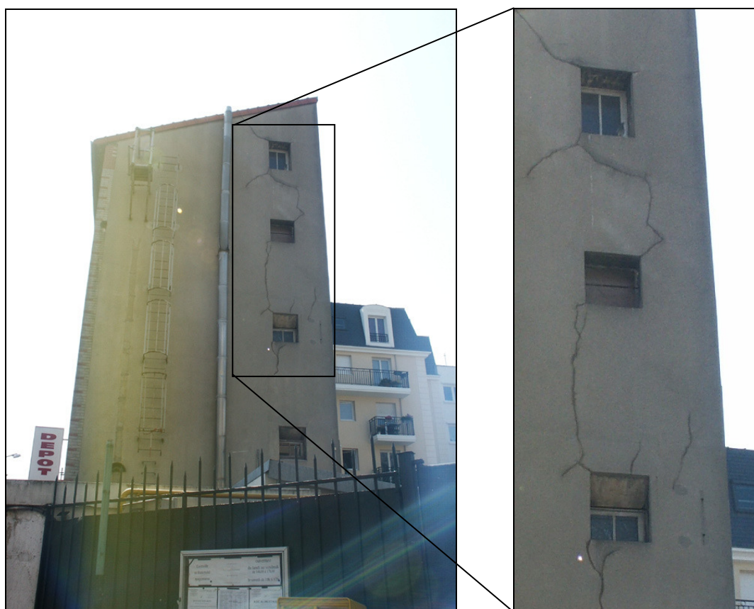
Position 1 : 2 Rue Charles VII, Nogent/Marne. Remarquer la dissymétrie des fissures qui révèle les déplacements du bâtiment. L'analyse détaillée des fentes de tension révèle que la partie droite du bâtiment descend relativement à la partie gauche en ouvrant des fentes d'extrados situées au coin des fenêtres.
