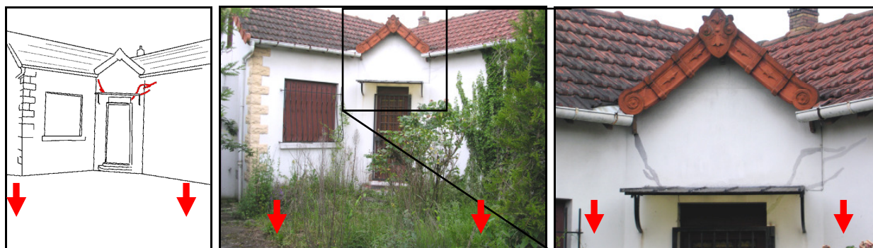
113 Rue Maison Blanche, à Neuilly/Marne, remarquer les affaissements des deux ailes du bâtiment (lié très probablement aux actions du RGA et à l'absence de fondations).
